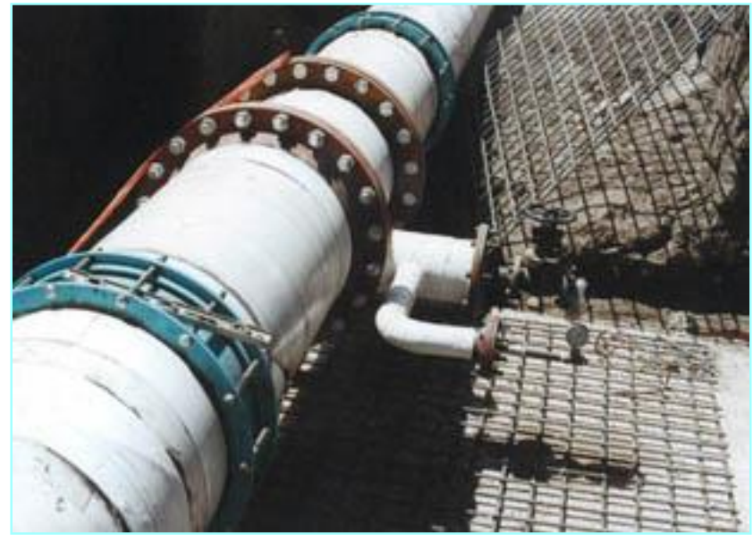
Válvula de drenaje y dos uniones tipo Dresser, una quedará dentro y la otra fuera de la cámara.
