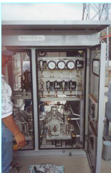
Gabinete de control y mando local, señalización de presiones.
