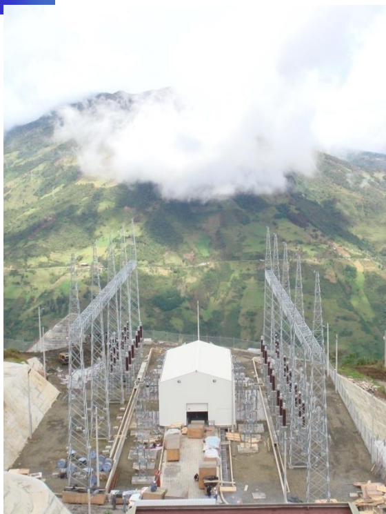
Subestación Zhoray, 230 KV en SF6 – Equipos: US$ 8'600,000.00
