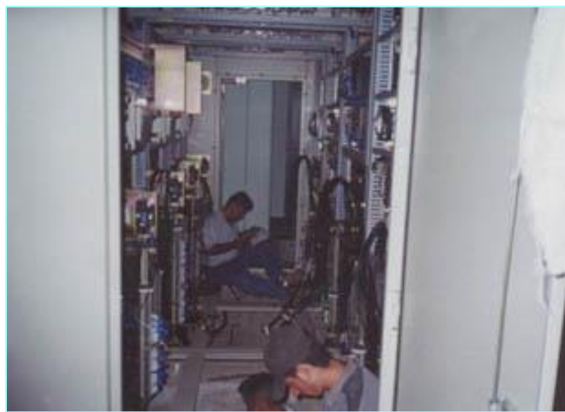
Conexión de los tableros duplex para control remoto
