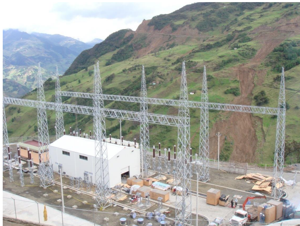
Pórticos de Salida de líneas a 230 KV para Mazar y Paute.
