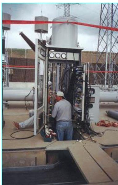
Conexión del gabinete de control
