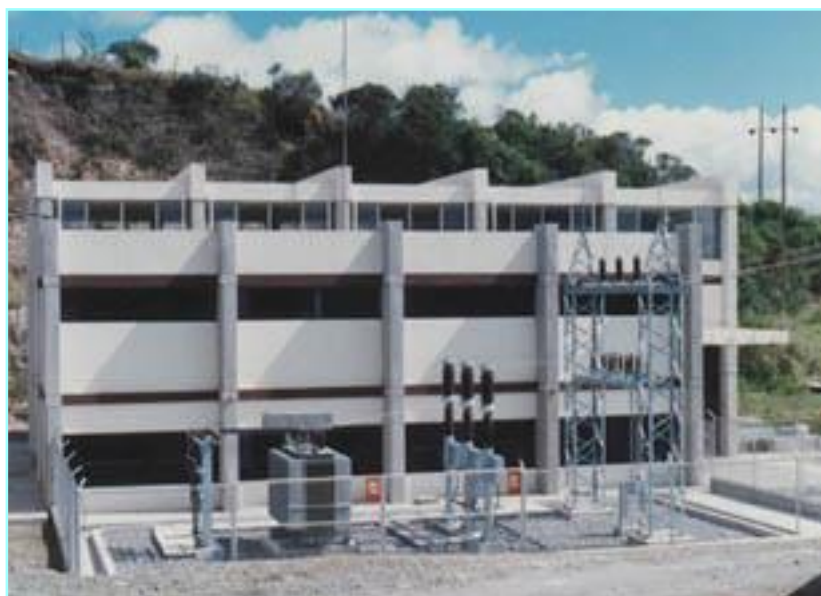
Mini-Subestación San Miguel de Car
